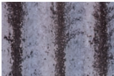
Cemento amianto corroso dalla carbonatazione
