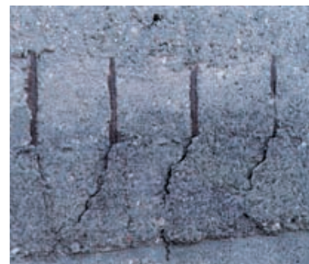
Fessurazione conseguente con scopertura tondini
